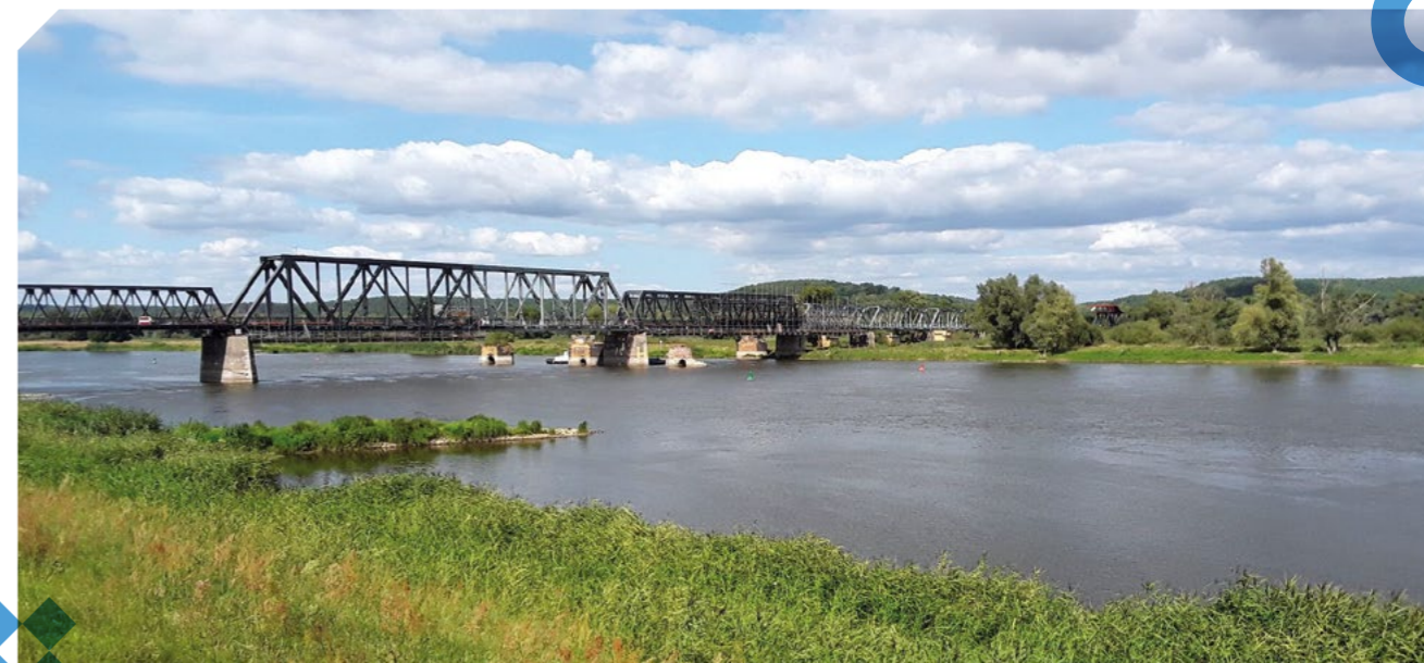
Remontowany most na Odrze między miejscowościami Neurüdnitz i Siekierki, który będzie nosił imię Władysława Bartoszewskiego. Dawny most kolejowy zostanie przeznaczony dla pieszych i rowerzystów jako lokalna atrakcja turystyczna.
